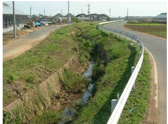
番号 45 小塩津放水路 (降雨時路肩に雨水が溜まるため危険)
