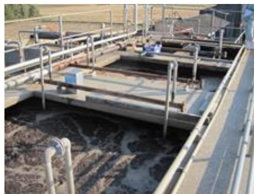
水質汚濁防止施設(浄化槽)
