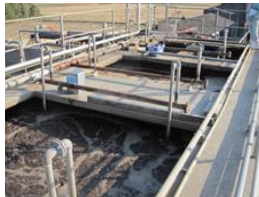
水質汚濁防止施設(浄化槽)
