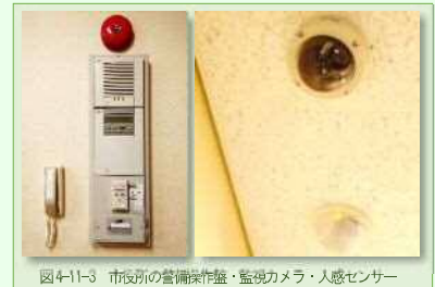
図4-11-3 市役所の警備操作盤・監視カメラ・人感センサー
