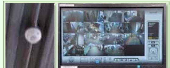
図4-11-4 庁舎立体駐車場防犯カメラ・防犯カメラディスプレイ・録画システム
