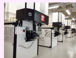
最新の排煙設備を備えた火葬炉
