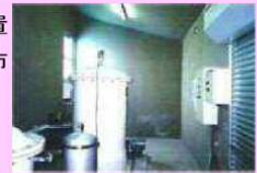
プールの水を利用した緊急用給水装置 徳島県吉野川市
