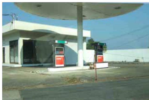
廃店舗の放置
