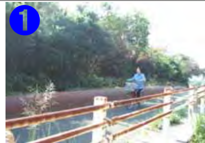
サイクリングコースでもあるが、ガードパイプが錆びて寂れた印象を与えている。
