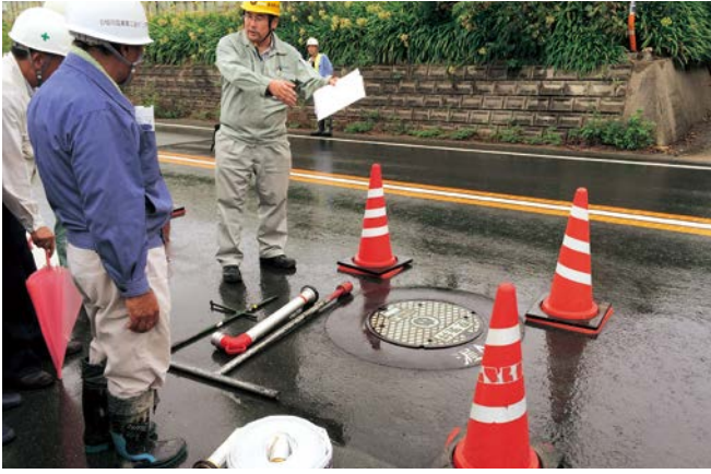
▲国道42号にある応急給水支援設備での訓練の様子
