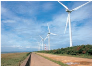
渥美風力発電所（小中山地内） 1500kW×7基
