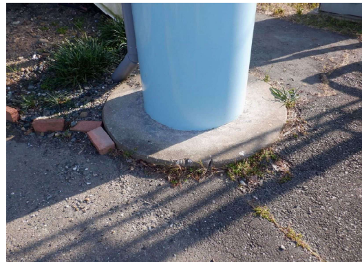
<剥離・鉄筋露出>
