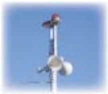
市内に設置されている防災行政無線
