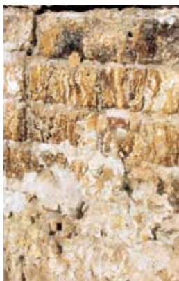
▲高温でガラス化した壁
