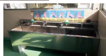
▼整備された設備 (手洗い場)
