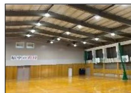
屋内運動場照明LED化後
