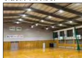
屋内運動場照明LED化後
