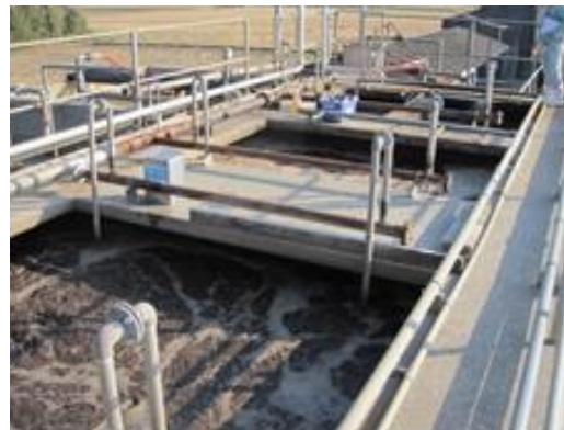
水質汚濁防止施設(浄化槽)
