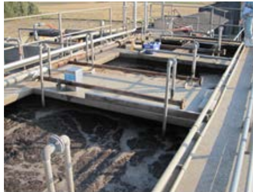
水質汚濁防止施設(浄化槽)
