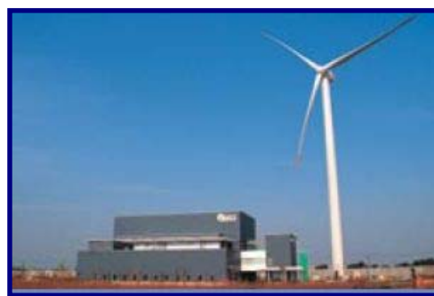
風力発電設備
