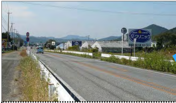
・雑草の繁茂した道路
