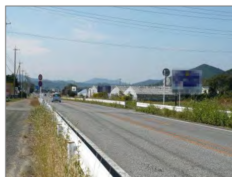
道路の雑草 (国道 259 号)
