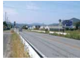
道路の雑草(国道259号)
