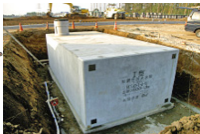
耐震性防火水槽
