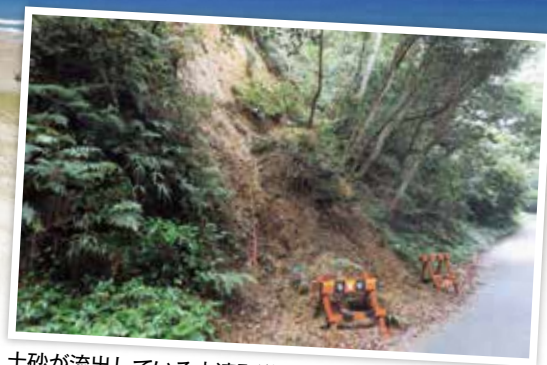
土砂が流出している六連町道盤
