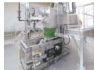
8 混練機・圧縮成形機 集じん灰を混練機にてキレー ト剤と混合し、安定化させた後 に最終処分場へ
