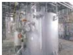
3 炭化物冷却洗浄槽 炭化物を水で冷却洗浄し、塩分 を除去
