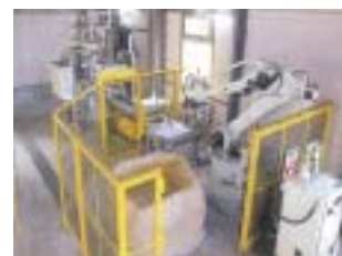
4 炭化物袋詰装置 炭化物の貯留・製品化
